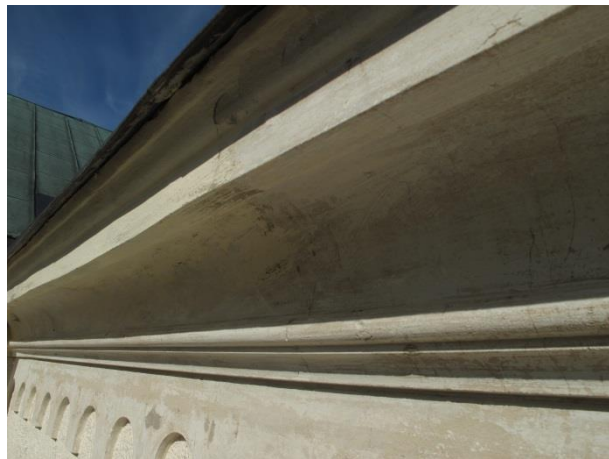
Den profilerade takfoten var mycket slät vilket gjorde att det kunde vara svårt att få färgen att fästa.
